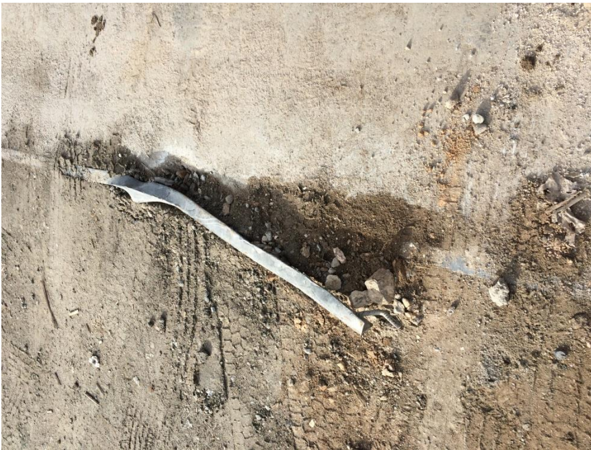
Photo 2 - Bris de la dalle de béton
