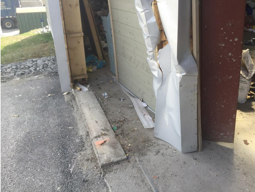
Photo 1 – Bris du mur du centre de transfert
